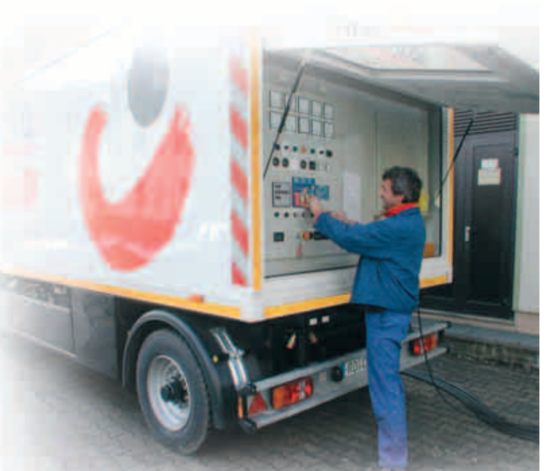
Günther Benstetter: „Das neue Notstromaggregat ist an jedem Ort im Netz einsetzbar.“
