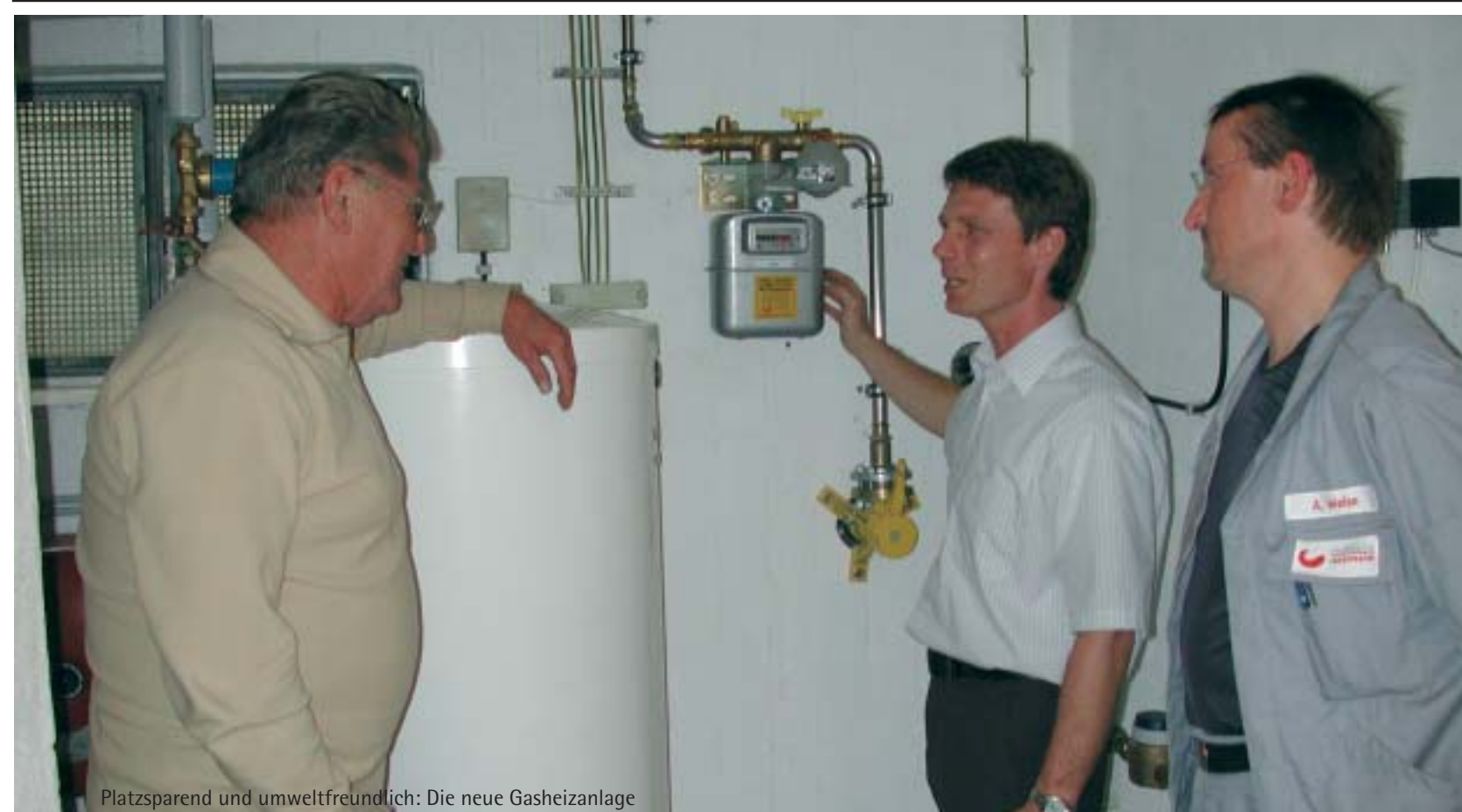
Platzsparend und umweltfreundlich: Die neue Gasheizanlage
