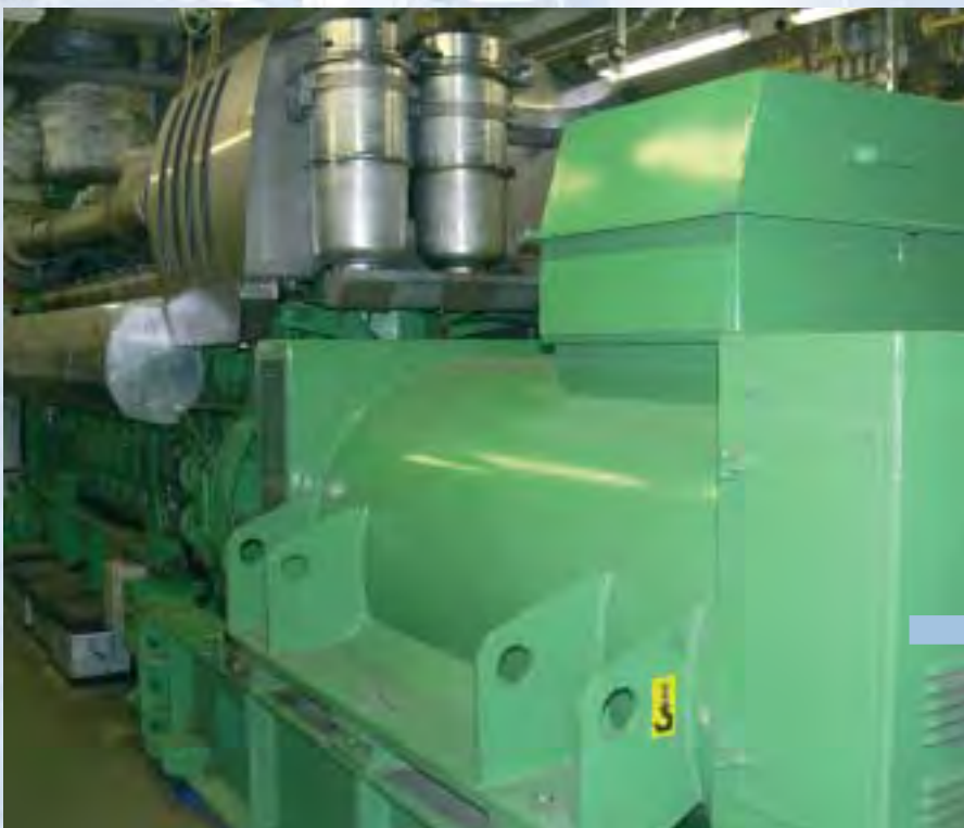
Neue Gasmotoren im Müllheizkraftwerk Rosenheim
